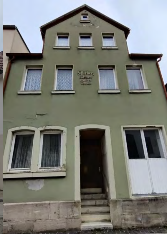
Sanierungsbedürftiges Wohngebäude in der Schuhmarktstraße
